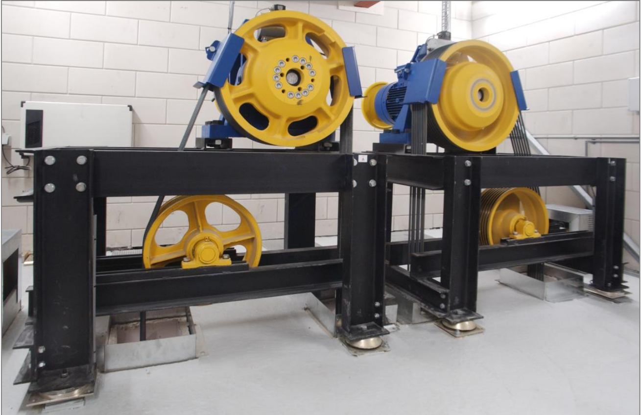
Fig. 2 | Kijkje in een liftmachinekamer
