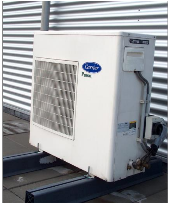
Fig. 1 | Voor sommige ruimtes, bijvoorbeeld een serverruimte, kan men ervoor kiezen om een aparte koelunit te plaatsen. Als de hoofdunit defect raakt, blijft deze ruimte toch gekoeld.
