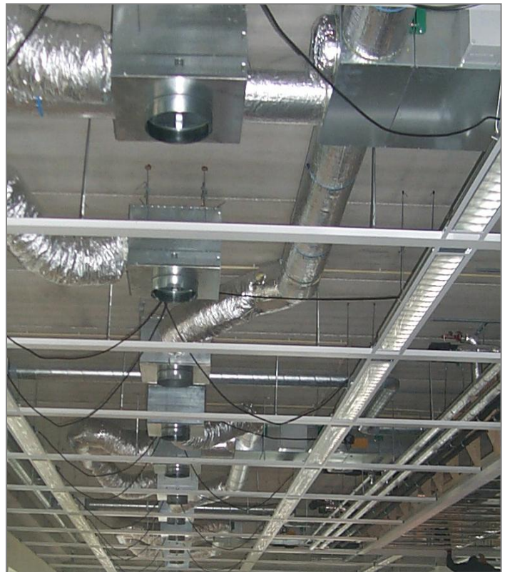
Fig. 1 | De luchtbehandelingsinstallatie wordt zichtbaar als de plafondplaten worden weggenomen...
