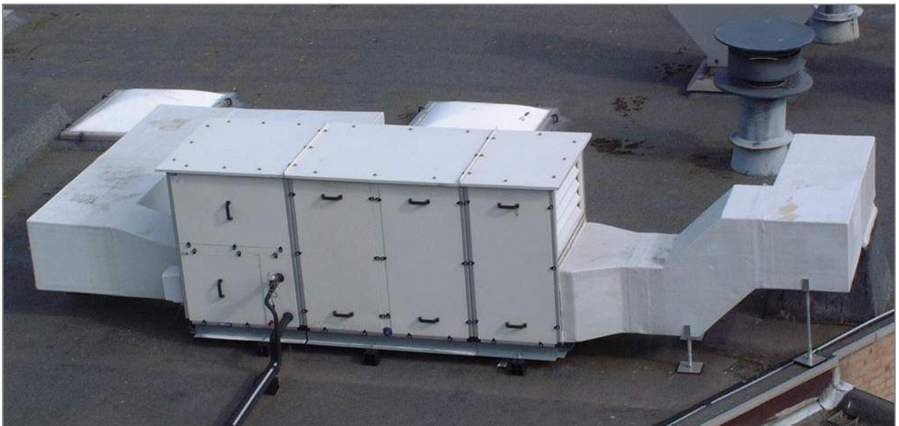
Fig. 2 | Luchtbehandelingsinstallatie op dak van gebouw
